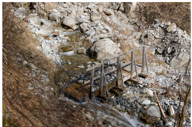
Le pont n'est plus très opérationnel.
